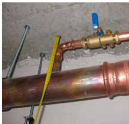
-Foto 1- Foutieve aansluiting brandslanghaspel
